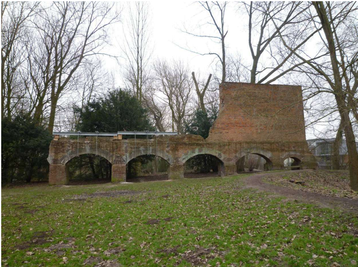
Foto: schietmuur in het Wantijpark, met consolidatiemaatregelen tegen het wegzakken. De restauratie zal begin 2015 starten.
